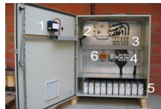
Figura 15 – Quadro de controle de fator de potência, composto por: 1) Controlador; 2) Chave seccionadora; 3) Fusíveis; 4) Contatores; 5) Capacitores; 6) Fonte de alimentação.
