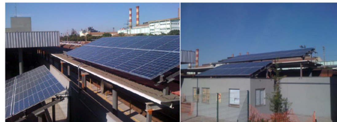
Figura 2 – Sistema fotovoltaico instalado sobre o telhado em uma estação de trem – Ipatinga, Minas Gerais.
